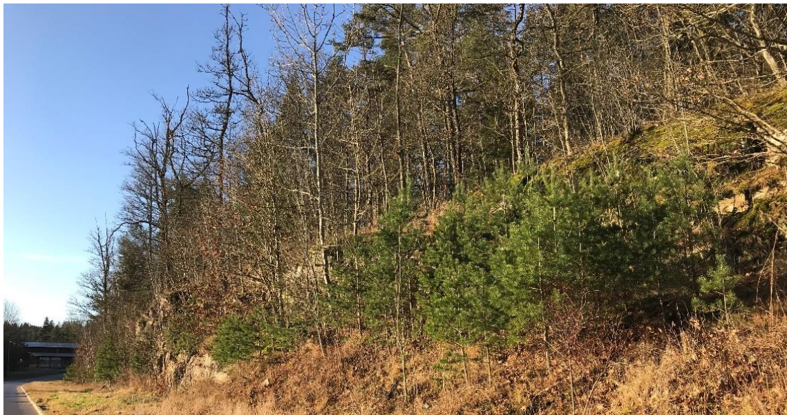
Figur 5. Branta bergslänter längs den östra sidan, COWI 2020-01-22.
