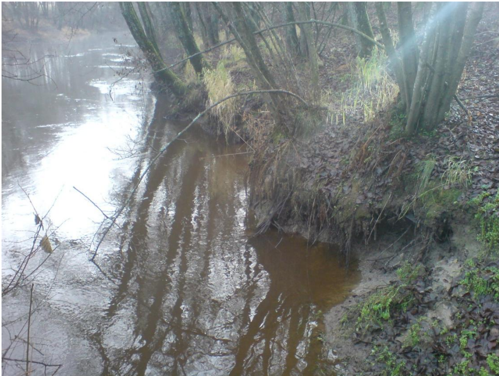
Bild 3. Pågående erosion vid platsen för den planerade bron över Säveån. Vy åt sydost.
